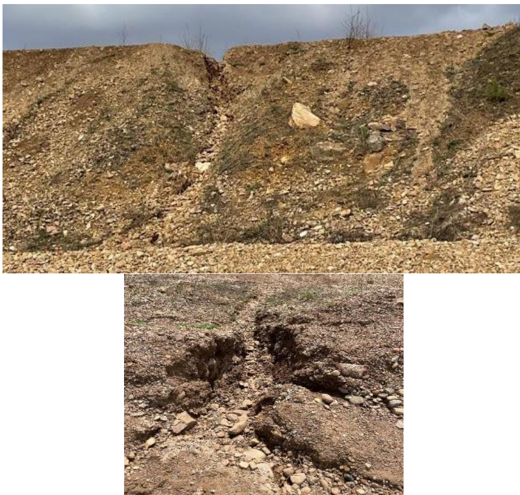
Рисунок 3 – Поверхностная эрозия откоса
