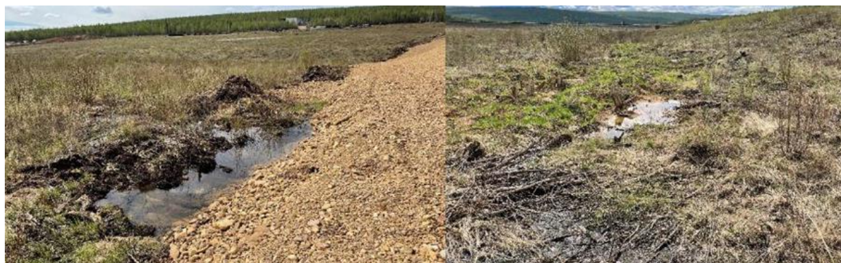
Рисунок 4 – Локальные участки скопления воды у подошвы низового откоса
